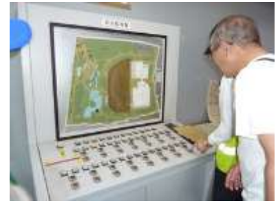
防災設備操作盤
